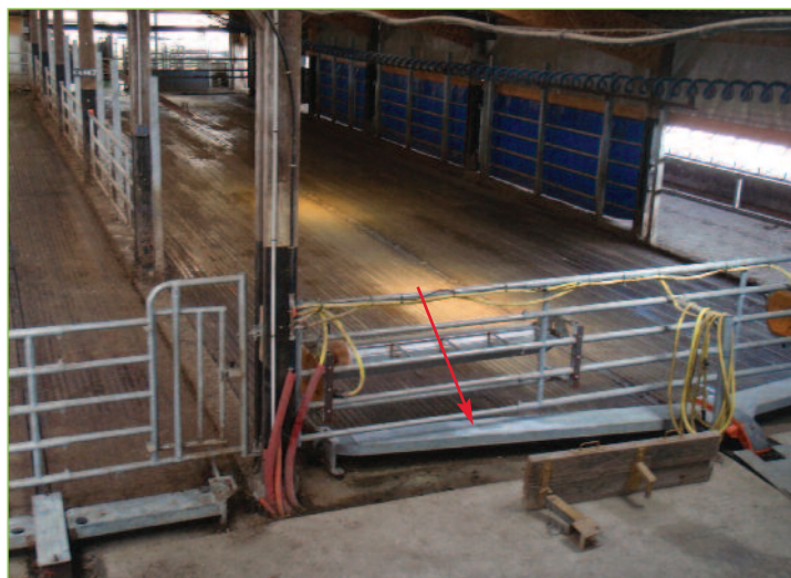
Photo 37 : Barrière poussante raclante.
